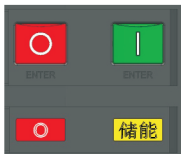
断路器断开且已储能完毕状态
