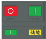
断路器合闸且已储能完毕状态
