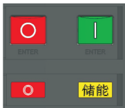
断路器断开且已储能完毕状态
