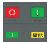
断路器合闸且已储能完毕状态
