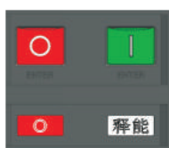
断路器断开且无储能状态
