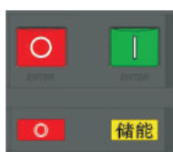
断路器断开且已储能完毕状态
