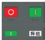
断路器合闸且无储能状态
